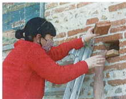
Figure 67. Obstruction partielle des trous de boulins
